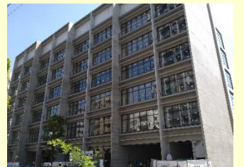
9月 大田区大森北四丁目複合施設5階、6階へ移転予定(5月工事中の写真)
